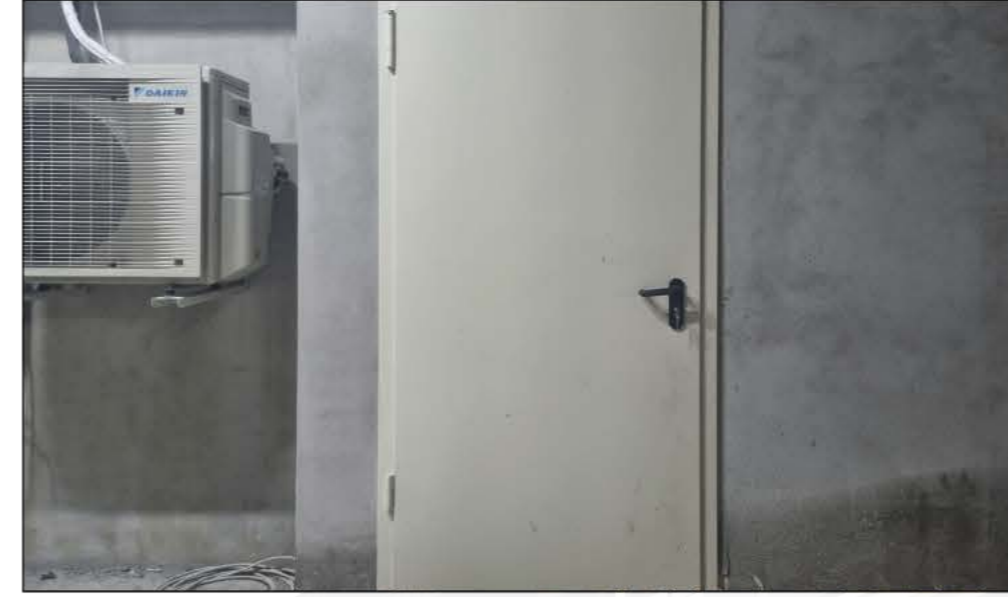
1 Yangın Kapısı Otopark Görünüşü
