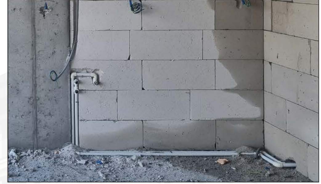
2 Mutfak Temiz Su Hattı
